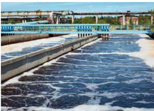
Очистка сточных вод
