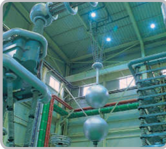
Испытание импульсом в лаборатории высоких напряжений
